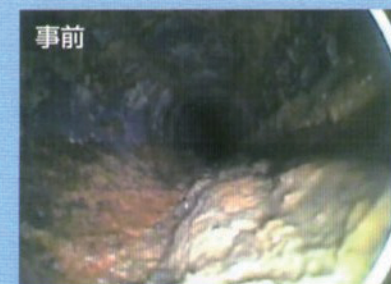
管径が断面縮小している
