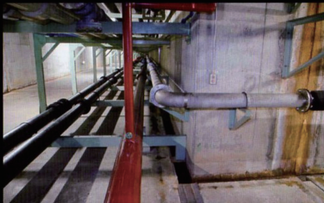
濃縮汚泥配管の様子(地下)
